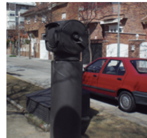
Buzones en red exterior de recogida neumática / Foto: L. Mellado
